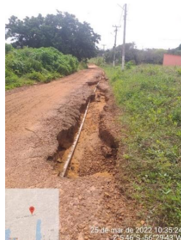
Figura 8. Via pública com registro de erosão e alagamento na estrada Maria Lopes. (Fonte: primeira autora).
